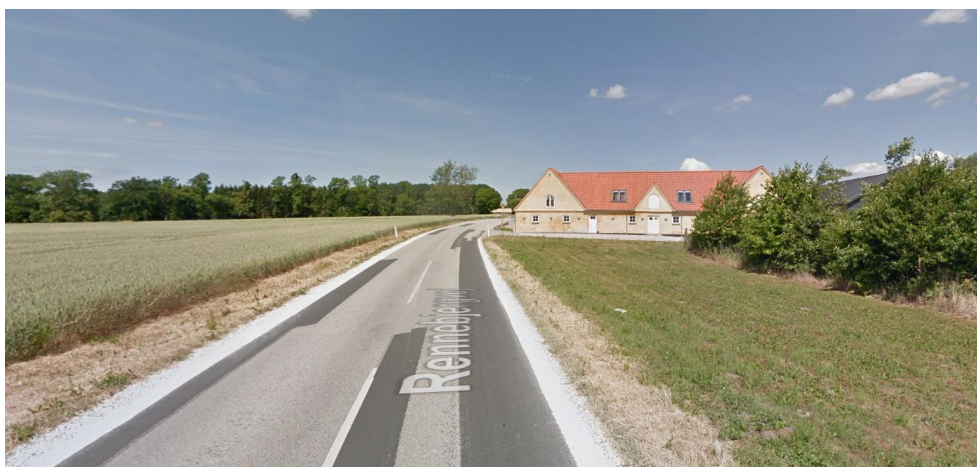
Fig. 3.5: Den nordlige del af BSM in-situ strækningen var før belægningsreoveringen også plaget af revner, krakeleringer og itukørte kanter, som var dækket af plet-OB og lapper.
