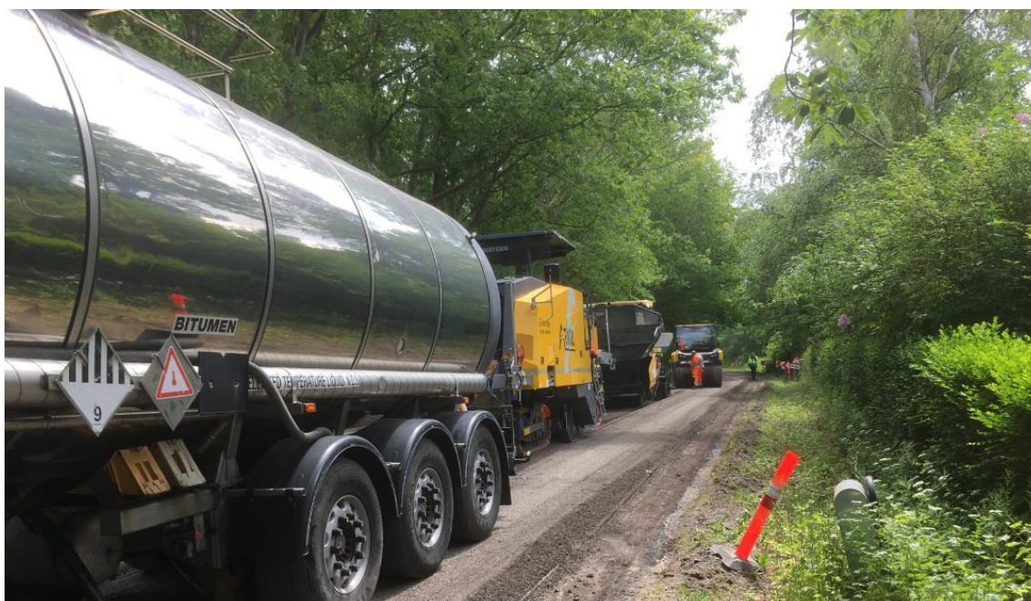
Fig. 4.3: Et kig hen ad den lange maskinrække ved BSM in-situ udlægning, hvor BSM både produceres og udlægges på én gang. Den lokale, uopvarmede BSM-produktion på stedet sparer transport- og opvarmningsenergi og opnår derved en lav CO 2 -udledning.
