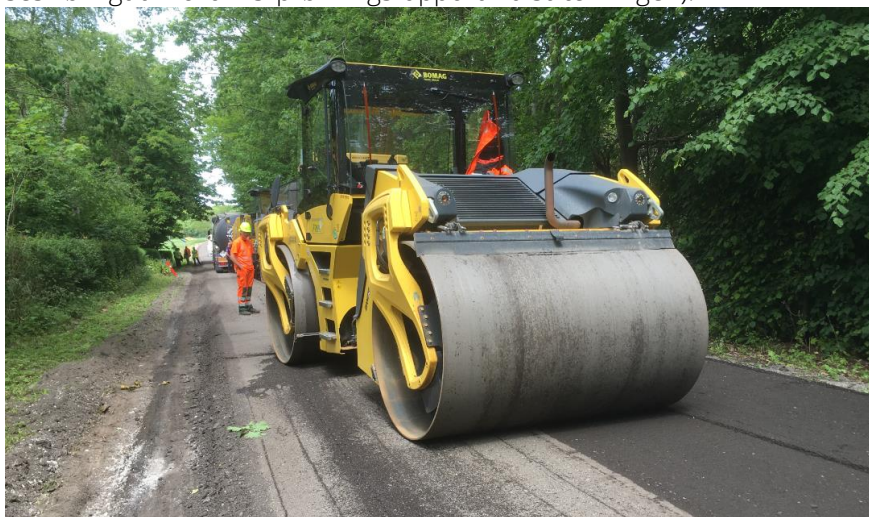
Fig. 6.1: BSM-laget blev af Arkil Asfalt udlagt med asfaltudlægger og efterfølgende komprimeret med såvel glatvalset vibrationstromle som gummihjulstromle.
